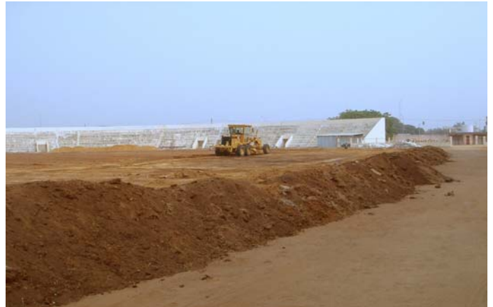
Las obras para homologar la cancha de fútbol comenzaron a mediados de 2006.
